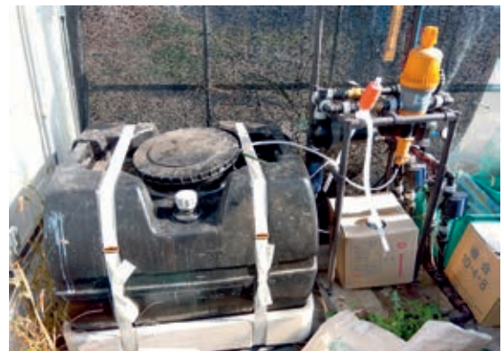
棟内に設置された自動灌水・液肥装置
